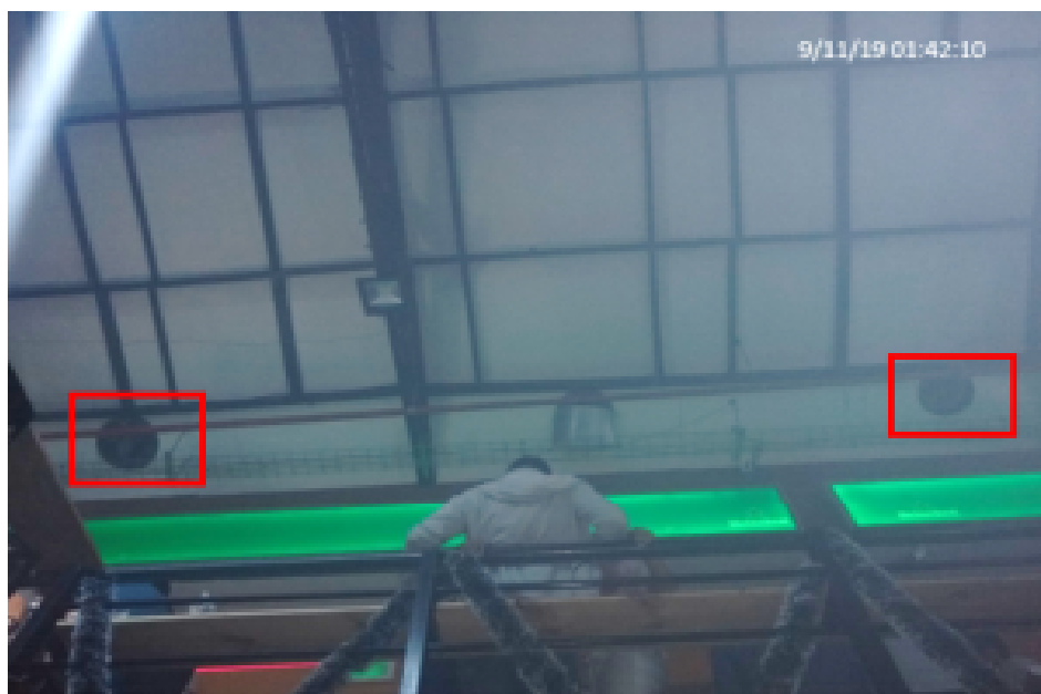
Fotografía No 15. Sistema de ventilación, costados (5 unidades por cada costado)
